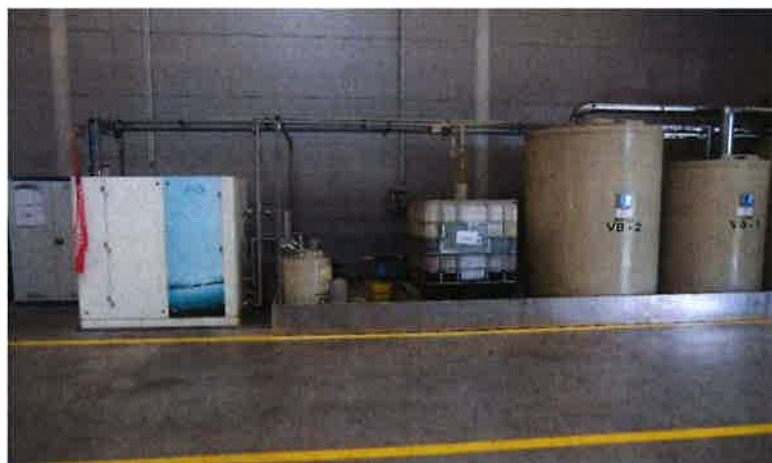
Vakuumverdampferanlage zur Aufarbeitung von Spülwässern
